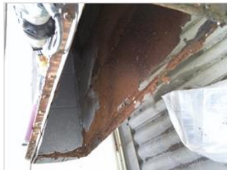
内部がさびた状態。自然災害で飛散する恐れも
